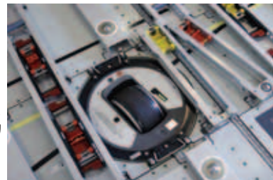
床面に埋め込まれたPDU。貨物を感知して自動的にせり上がり、滑りがないよう適切な強さで所定の位置まで送ることができる。
